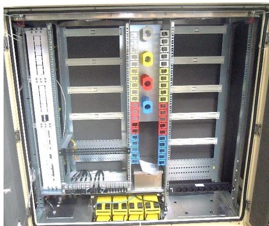
Vue intérieure d'une armoire non équipée
